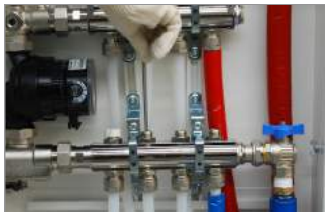
9. Riempimento impianto: chiusura dei successivi detentori ruotando la chiave a brugola in senso orario Filling the system: close the following lockshields by turning the Allen wrench clockwise
